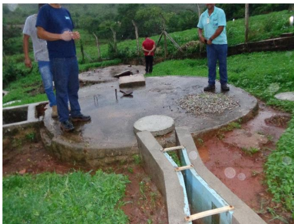
Imagem 2. Calha Parshall/Reator UASB
